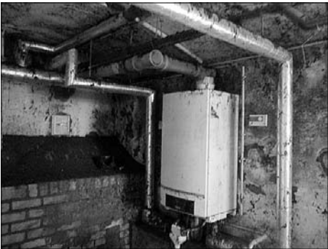
Der Keller der ehemaligen Schule stand bis zur Decke unter Wasser und Schlamm.
