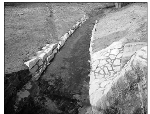
die „Erneuerung Ufermauer an der Hauptstraße“ in Angriff genommen und beendet werden.
