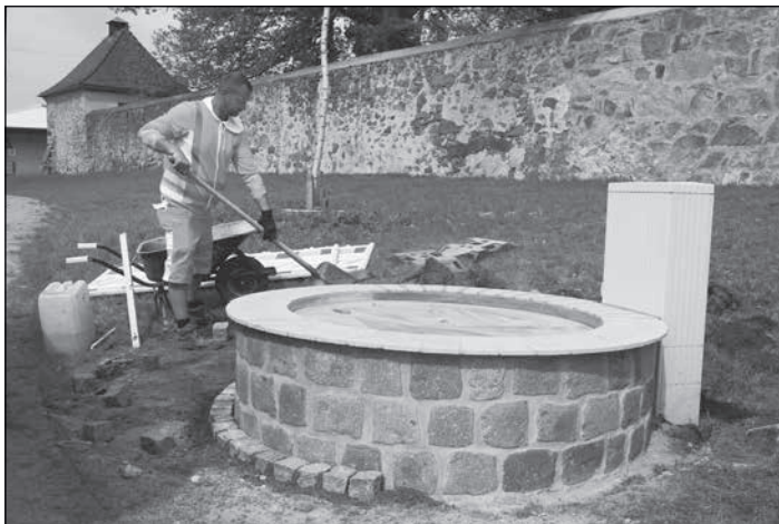
Maik Pompe, Mitarbeiter des Technischen Dienstes beim Setzen der Umrandung des Brunnen
